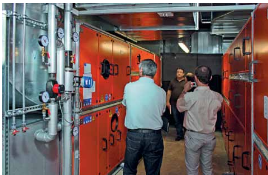
Schulzentrum in Mössingen, Baden-Württemberg. Klimatisierungsanlage im Untergeschoss mit 15.660 m 3 Nennluftvolumen/Stunde für die Klassenräume und 9.000 m 3 Nennluftvolumen/Stunde für die Mensa. Die adiabate Abluftkühlung erzeugt hierbei 156 kW bzw. 90 kW bei maximalem Volumenstrom.
