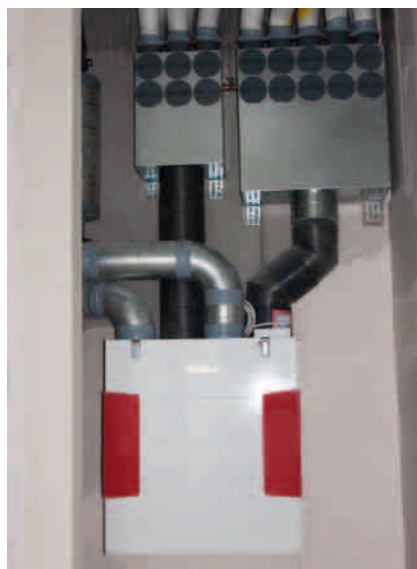
In den neugebauten Mehrfamilienhäusern wurden die KWL-Wandgeräte unsichtbar in den Hauswirtschaftsräumen installiert.
