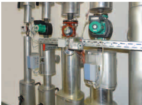
Heizzentrale mit Wärmezähler UltraLite (ganz links) und mechan. Volumenmessteil.
