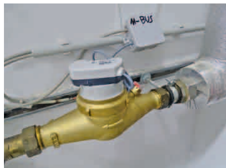
Identische Baulängen: Ersatz des alten Zählers durch MSD ohne Umbaumaßnahmen.
