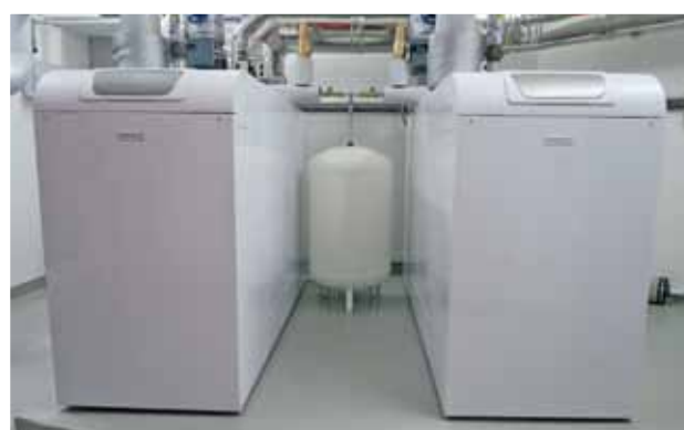
Die beiden Gasbrennwertkessel der Serie SGB 610i sind in Kaskade geschaltet.
