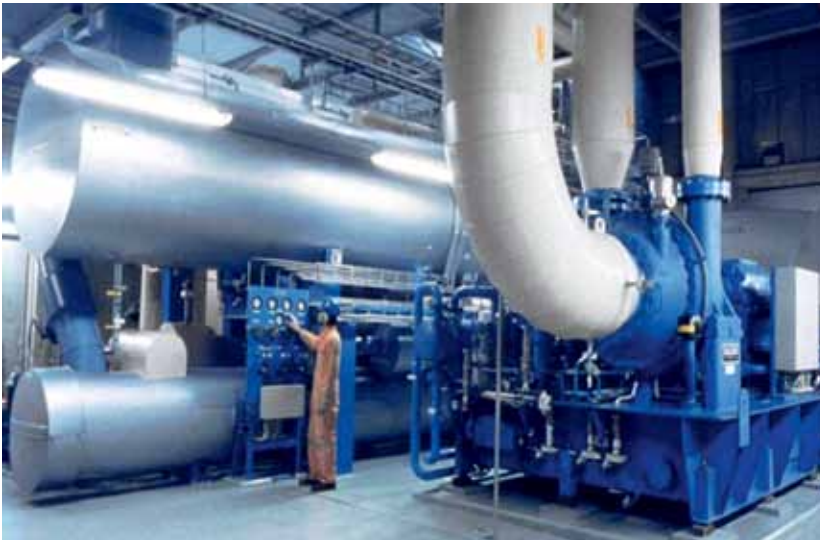
1988: Für das Fernheizungssystem von Stockholm wird das weltgrößte Wärmepumpensystem (sechs Wärmepumpen mit insgesamt 180 MW) mit Meerwasser als Wärmequelle in Betrieb genommen: Värtan Ropsten
