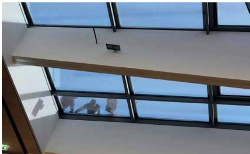
Automatisierte Dachfensteröffnungen helfen bei der Entrauchung.
