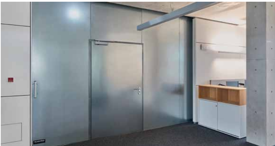
DAS SCHIEBETOR erfüllt die notwendigen Normen zum Brandschutz
